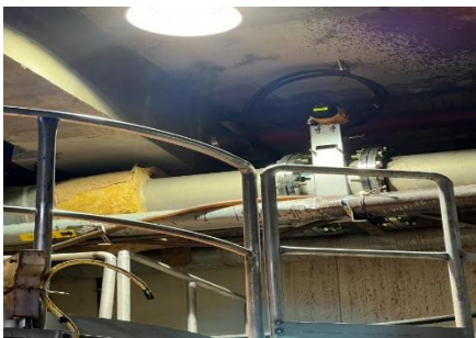
테림페이퍼 마산공장 Main Steam 400A 라인 FN질량유량계
