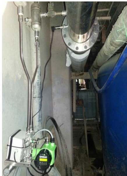
경산제지 달성공장 Main 스팀 250A 라인 FN질량유량계
